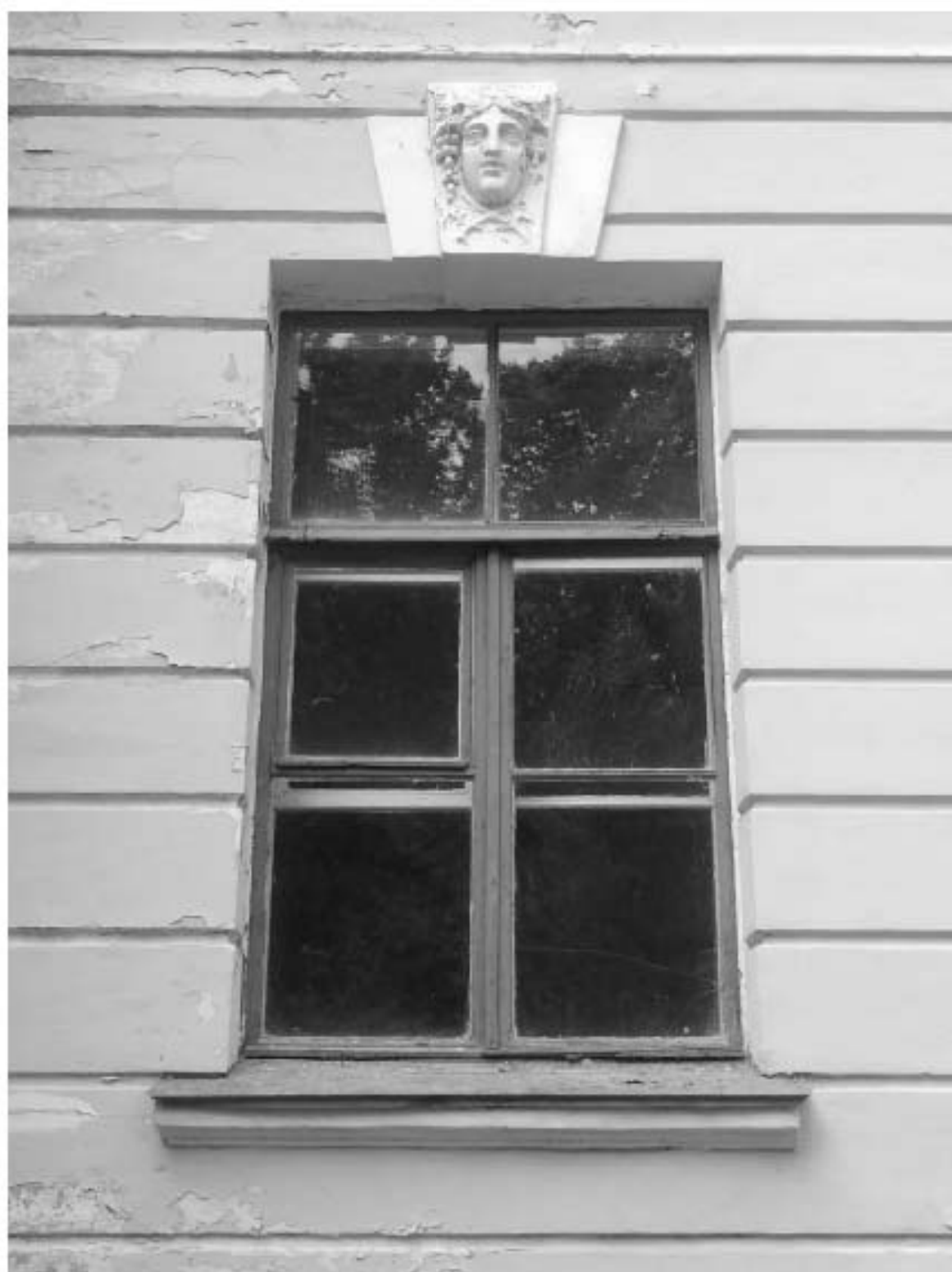
Фото 06. РЗ ОКН «Загородный дом Ф.Р. Витцеля». Восточный фасад. Фрагмент. Оконный проём состояние штукатурного слоя. Съёмка 25.07.2019 г.
