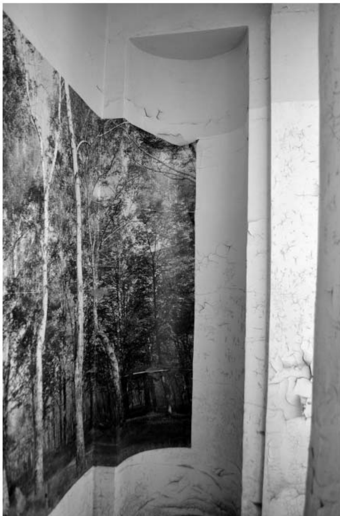
Фото 53. РЗ ОКН «Загородный дом Ф.Р. Витцеля». 1-ый этаж. Помещение № 5. Фрагмент. Полуциркулярная ниша. Съёмка 25.07.2019 г.
