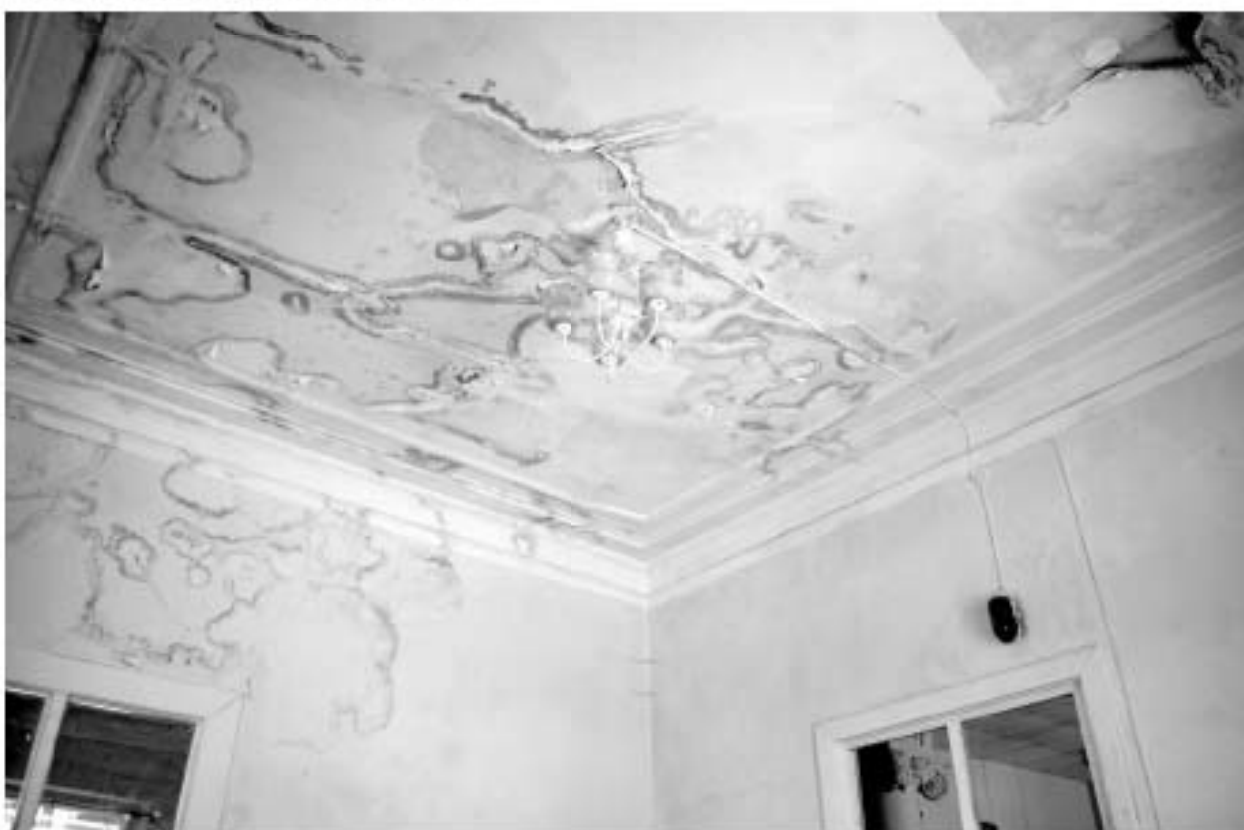
Фото 50. РЗ ОКН «Загородный дом Ф.Р. Витцеля». 1-ый этаж. Помещение № 4. Потолок. Съёмка 25.07.2019 г.
