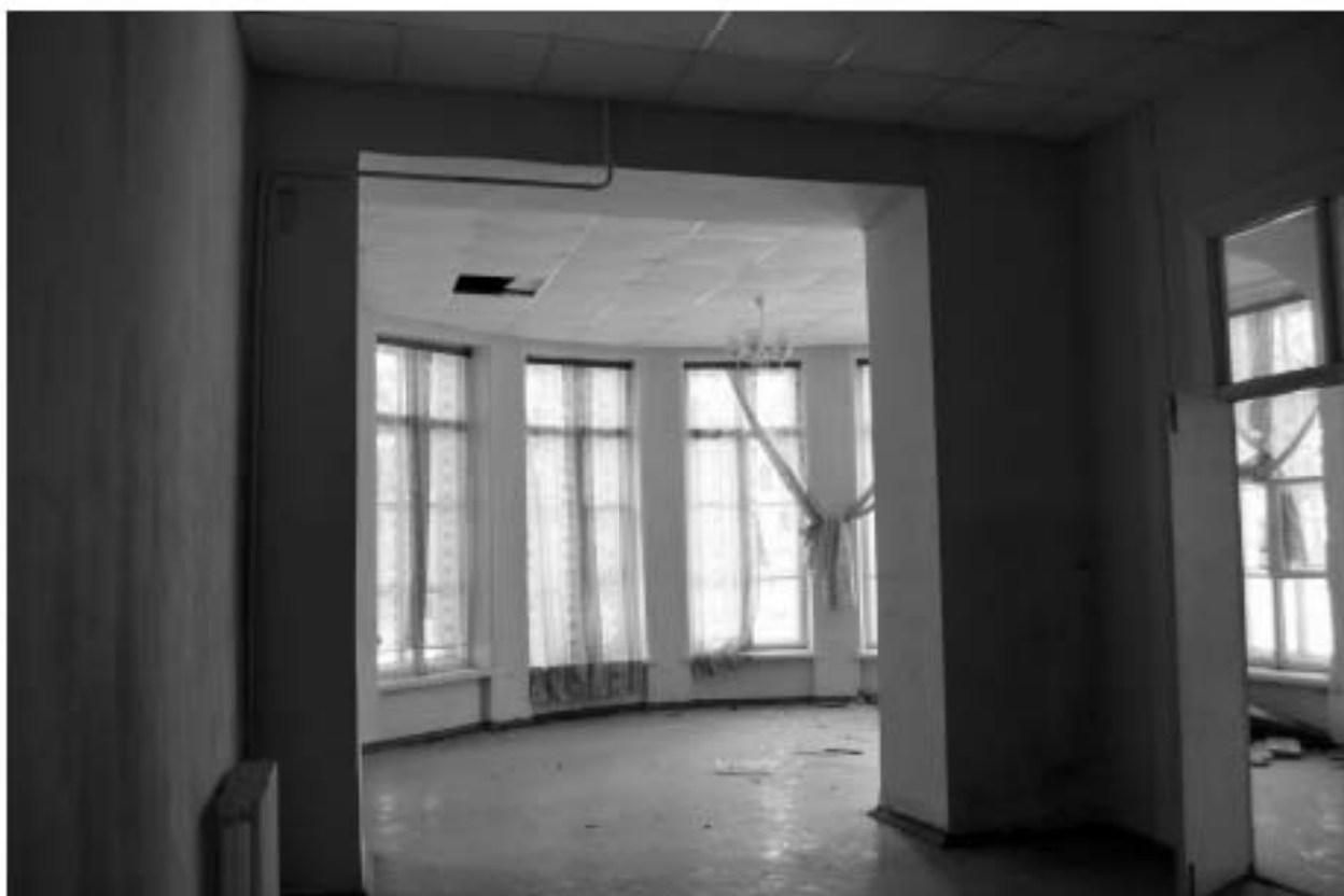
Фото 56. РЗ ОКН «Загородный дом Ф.Р. Витцеля». 1-ый этаж. Вид из помещения № 7 на помещение № 11. Общий вид. Съёмка 25.07.2019 г.
