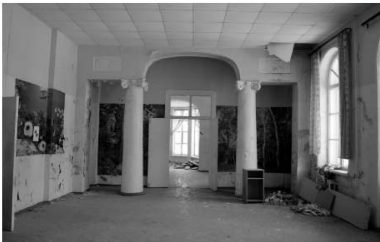
Фото 51. РЗ ОКН «Загородный дом Ф.Р. Витцеля». 1-ый этаж. Помещение № 5. Общий вид. Съёмка 25.07.2019 г.
