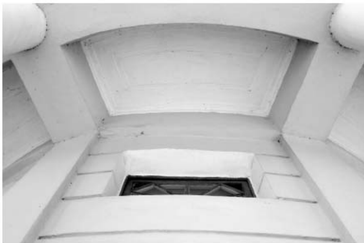
Фото 04. РЗ ОКН «Загородный дом Ф.Р. Витцеля». Восточный фасад. Фрагмент. Полуротонда. Кессоны в потолочном перекрытии между колоннами и стеной. Съёмка 25.07.2019 г.
