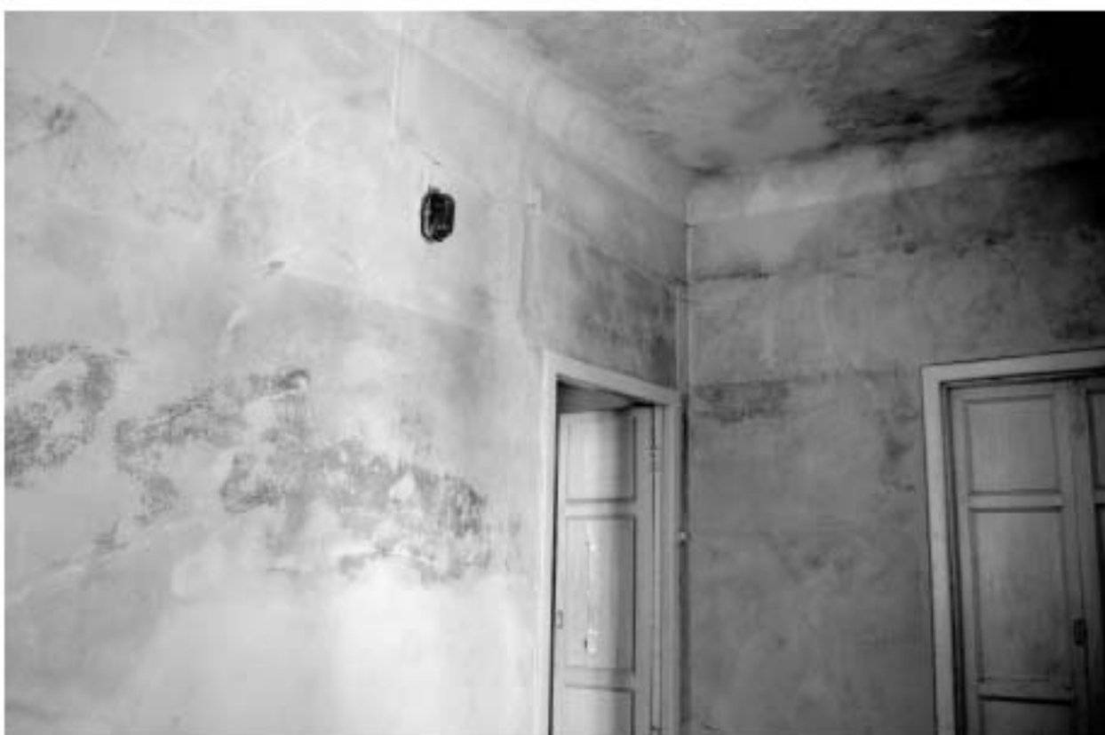
Фото 75. РЗ ОКН «Загородный дом Ф.Р. Витцеля». 2-ой этаж. Помещение № 22. Общий вид. Дверные проёмы. Съёмка 25.07.2019 г.
